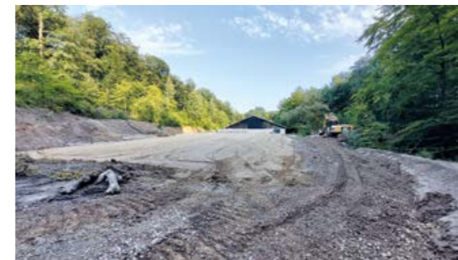
Zugeschüttet: Unter dieser geplanten Fläche soll sich jede Menge Müll verbergen
