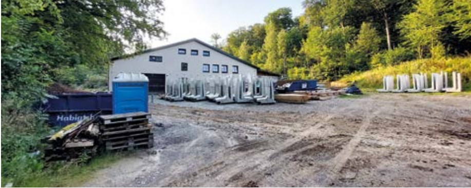
Tatort Bergkamp 15: Eine große Talfläche wurde für den Ausbau der Reitanlage geplant. Umfangreiches Baumaterial liegt bereit.
