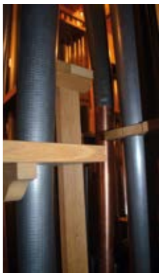
Neigen sich: Alle Pfeifen müssen raus und instandgesetzt werden.
