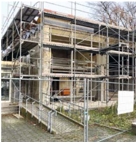
Noch vor einem Jahr: Der Sanierungsfall wirkt wie eine Bauruine.
