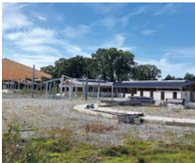
Stillstand: Die Ranch wird langsam von der Baustelle zur Bauruine.
