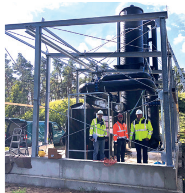
Fachleute: Peter Hildebrand (Stadtwerke, v.l.), Martin Hobl (Planungsbüro GU) und Thomas Grieger (Firma Dahmen) sind für Planung und Bau der Aufbereitungsanlage verantwortlich.
