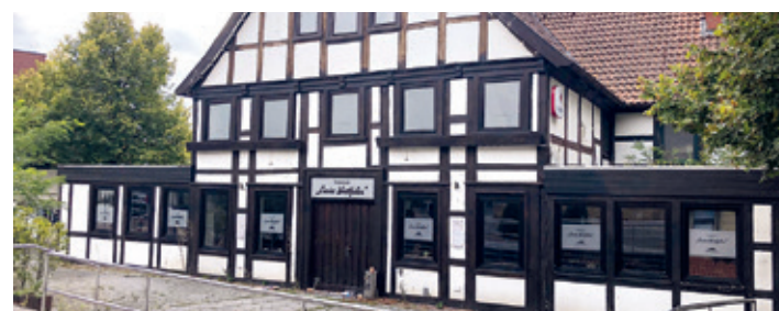
Nicht wirklich in Schuss: Der markante Fachwerkbau aus dem Jahr 1777 hat schon mal bessere Zeiten gesehen.
