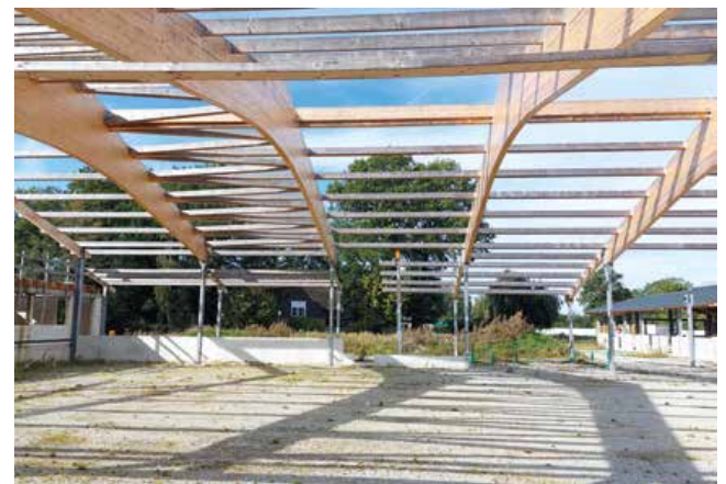
Einsam und verlassen: Auf der Baustelle der „Riding Ranch“ mussten alle Arbeiten eingestellt werden.
